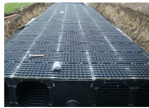
Enregis Rückhalte- und Versickerungsbecken für Regenwasser.
